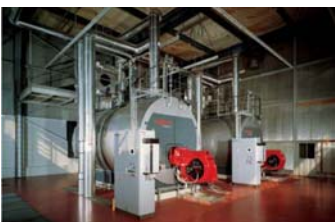
Energiezentrale Siemens-Areal, Zug
